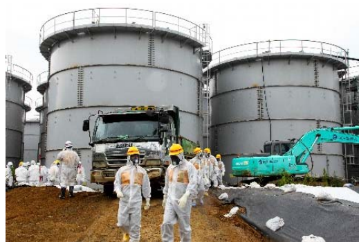
タンクから汚染水漏れ（東京電力提供）
