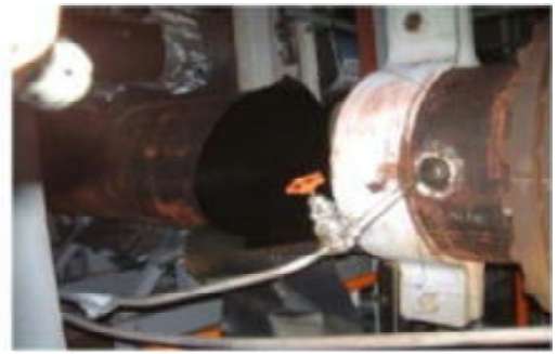
美浜3号2次系配管開口破断事故 (2004.8.9 腐食による破断、定検準備中の下請労働者5名死亡、6名火傷)
